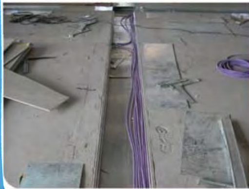
k) Vista de tapa y cableado en canal a ras del pavimento.
