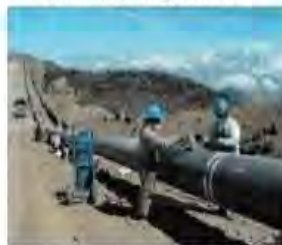
Gasoducto de Transporte
